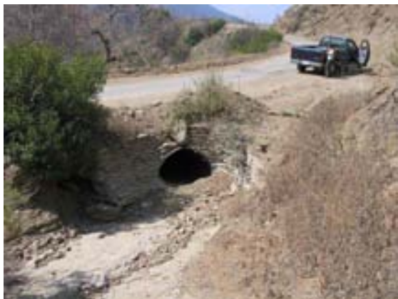
Fig. A. 13. Culvert cleanout 104_0419a
